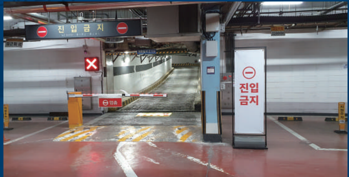
중앙몰 주차장내 교통차단기
